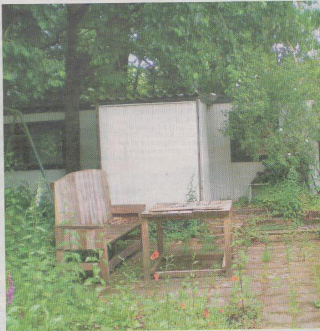
Op de achtergrond de caravan die zeventien jaar geleden zonder bouwvergunning is geplaatst. Rechts voorjes, die door gebrek aan onderhoud op instorten staan.
